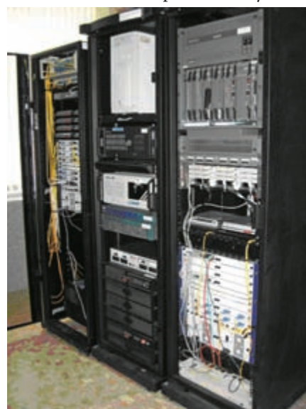
Рис 1. Центральный коммутационный узел ИМТС ГУ МВД России по Челябинской области
